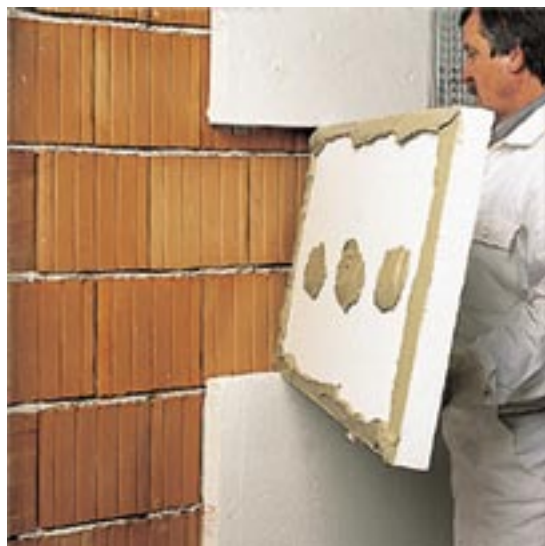
Abb 29 | Kleberauftrag: Damit sich die Dämmplatten nicht nach einiger Zeit wölben und die Dämmung hinterströmt wird (Matratzenefekt), muss der Kleber nach der Punkt-Wulst-Methode aufgebracht werden.
