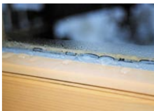
Abb 41 | Kondenswasser im Randbereich des Fensters
